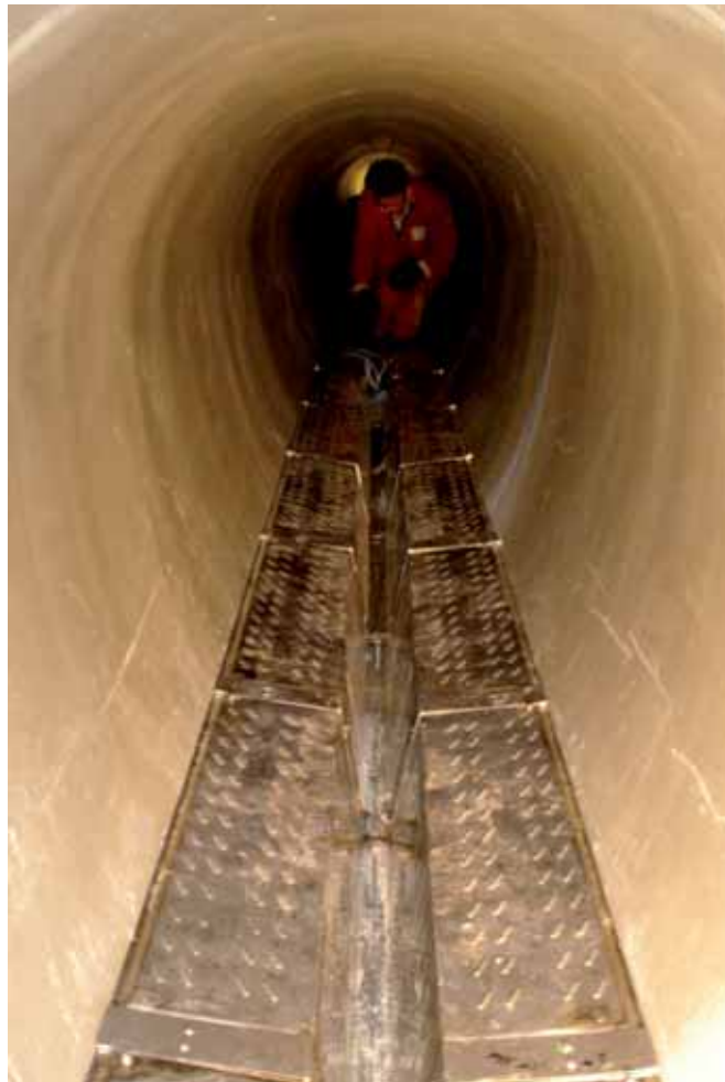
Das innovative Wärmetauschersystem „Therm-Liner“ nutzt die Energie aus Kanälen für Heizung und Kühlung von Gebäuden. Mit speziellen Edelstahlwärmetauschern (auf dem Boden des Kanals) wird dem Abwasser Wärme entzogen und verwendet.
