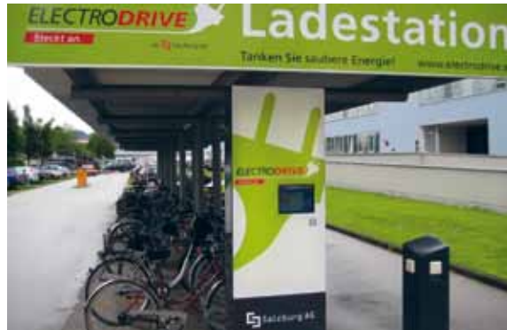
Öffentliche E-Radladestation in Salzburg, Foto: Österreichische Energieagentur
